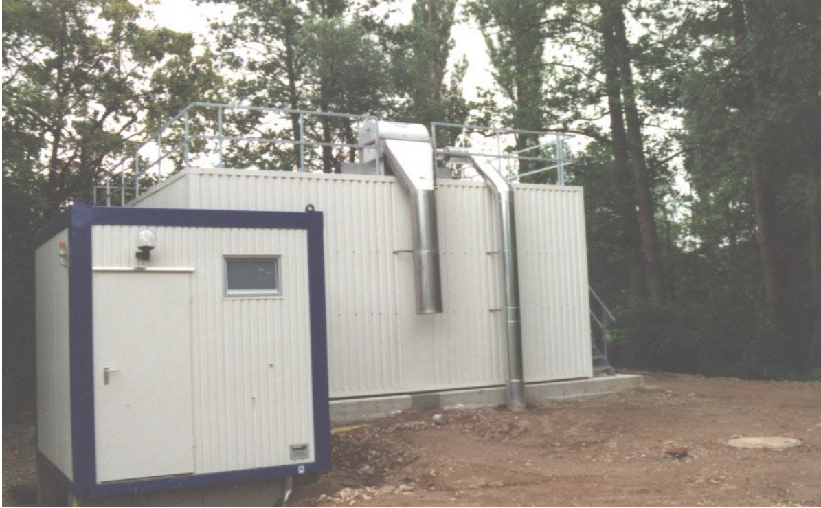
Sewage Plant - 800 PE
