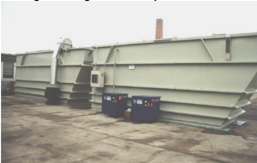
Sewage Plant - 500 PE
