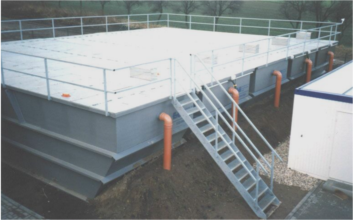
Sewage Plant - 5,000 PE
